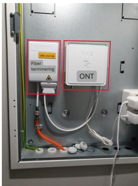
Bild. Exempel på ONT monterad i ett mediaskåp
