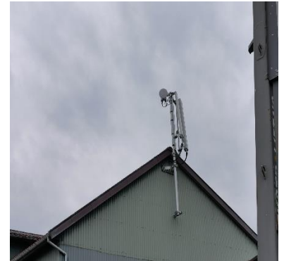
Antennbärartyp: byggnad vägg
