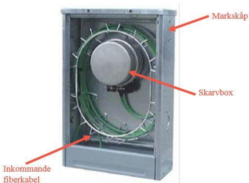
Bild - Exempel på kopplings-skåp / markskåp med skarvbox
