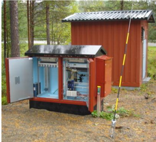
Exempel utomhusskåp för byanod (Telia telestation i bakgrunden)
